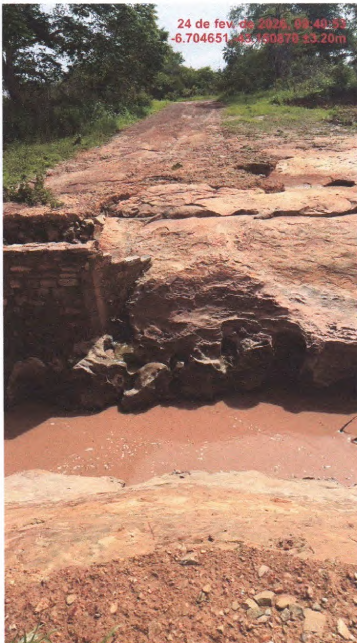
Figura 2: Estrutura colapsada da ponte
